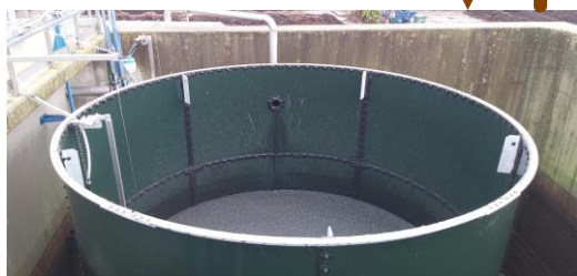
Zbiornik buforowy osadu zagęszczonego
