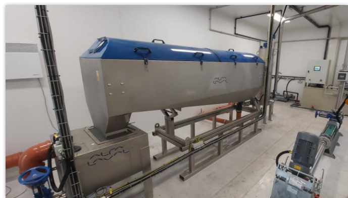
Zagęszczacz mechaniczny + pompownia osadu zagęszczonego
