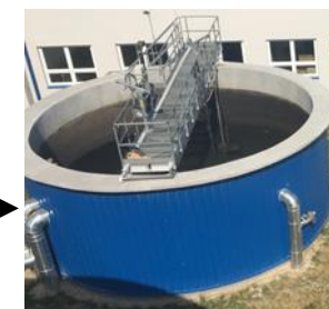
Zbiornik osadu przefermentowanego
