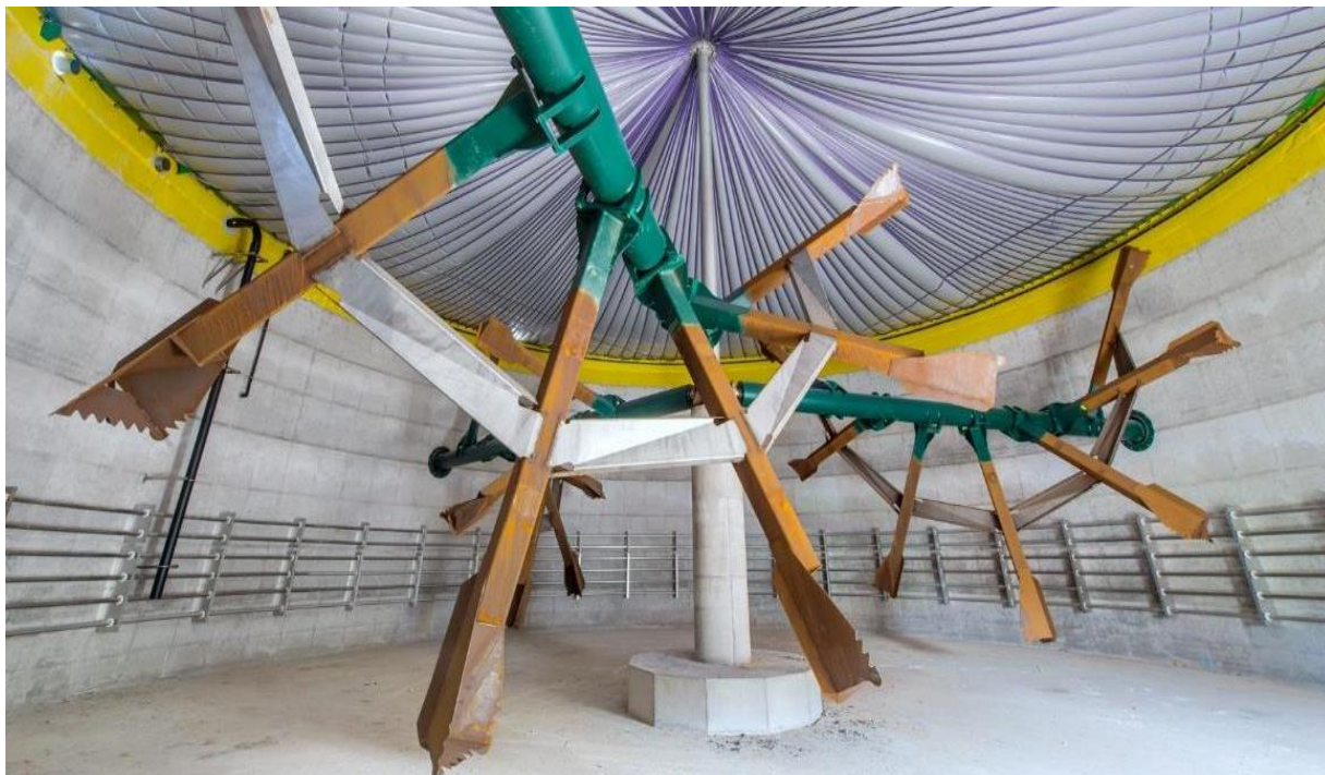
Fot. 3. System mieszania wewnątrz reaktora fermentacji
