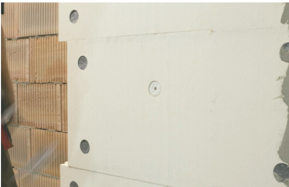
Zdjęcie nr. 16. Widok zagłębionego kołka.
