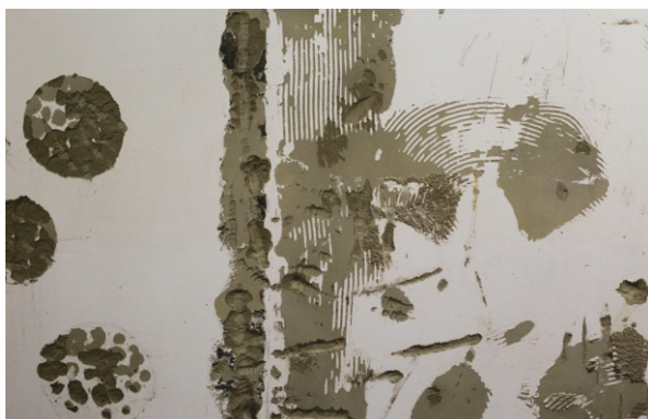
Zdjęcie nr 1. Ubytki do wypełnienia klejem.
