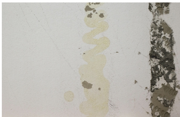
Zdjęcie nr 4. Plamy mogące zmniejszyć przyczepność kleju.
