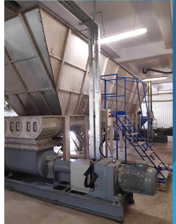
Zbiornik osadu z ruchomym dnem po wirówkach, pompy nadawy osadu na hydrolizę.
