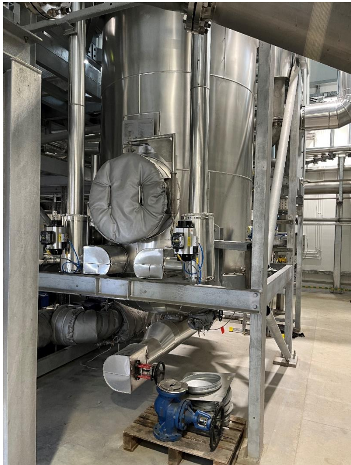
Instalacja hydrolizy - zbiornik przygotowania osadu.
