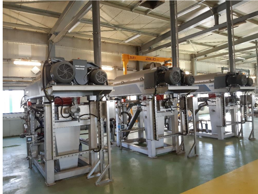
Wirówki dekantacyjne - odwadnianie osadu przed hydrolizą.
