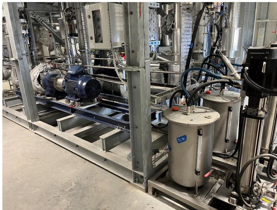
Instalacja hydrolizy - mieszacz dynamiczny.
