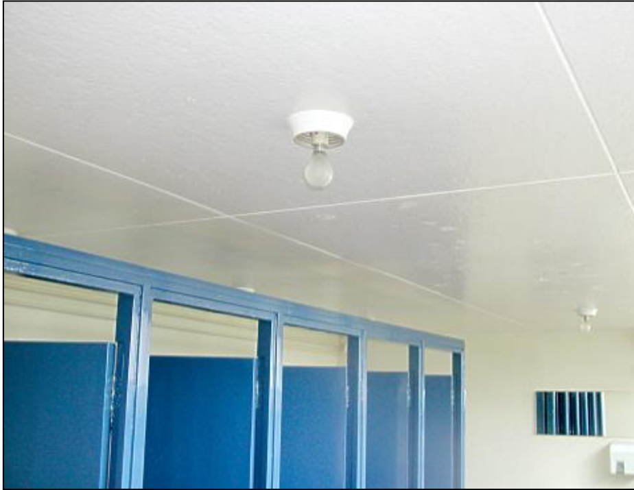
Tecto com placas de isolamento de Amianto
