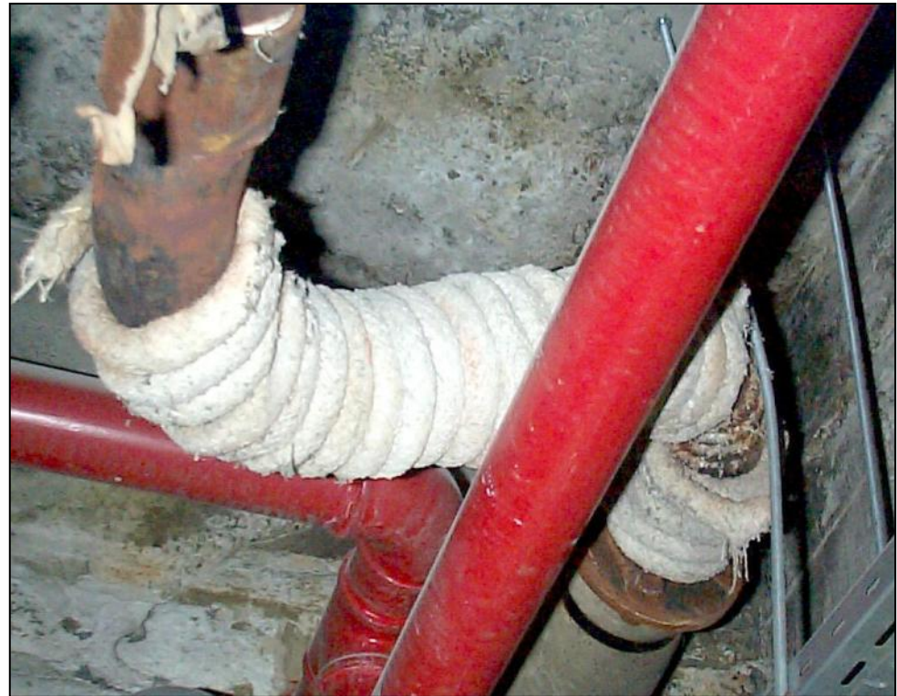
Isolamento em cordas em volta de tubagem
