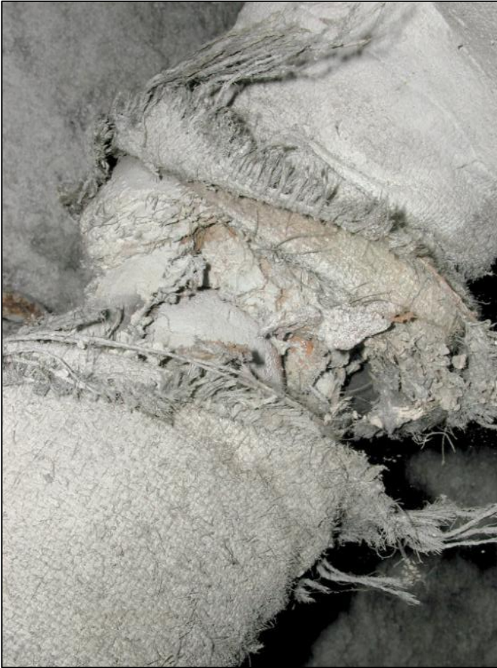
Isolamento em tecido em volta de tubagem
