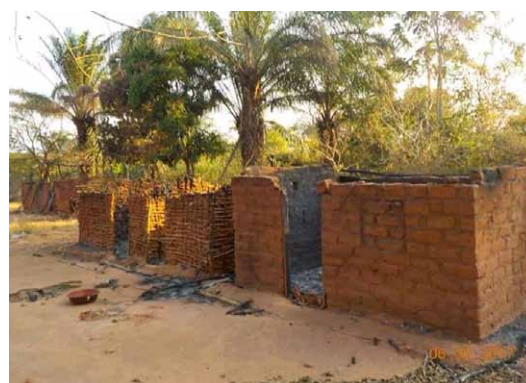
Maisons ayant perdu la tôle de couverture probablement à cause d'une situation de conflit près de Kalemie, Tanganyika. Les tôles sont souvent volées ou vendues en cas de besoin. © A. Mbumb Kazemb
