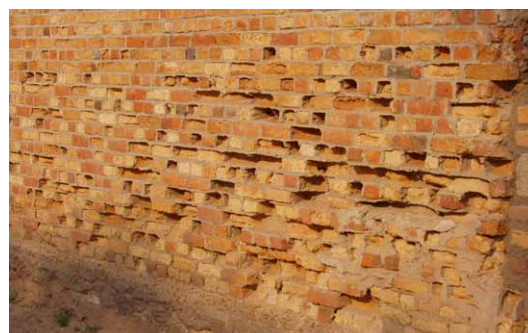
Les remontées d'humidité par le sol sont très régulières et les briques sont érodées plus rapidement que si elles étaient protégées par un soubassement. La base des murs est très sollicitée, demandant une plus grande épaisseur en cet endroit. Si les briques sont de mauvaise qualité le problème est encore plus important. Bâtiment à Kabalo, Tanganyika. © CRAterre
