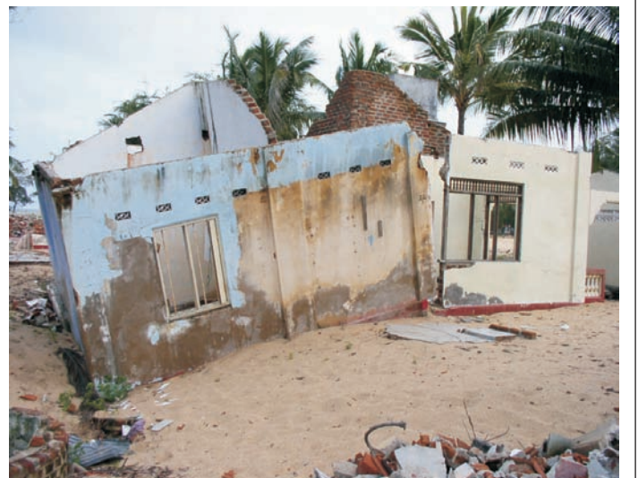
नींव के जमीन में धंस जाने से क्षतिग्रस्त भवन
