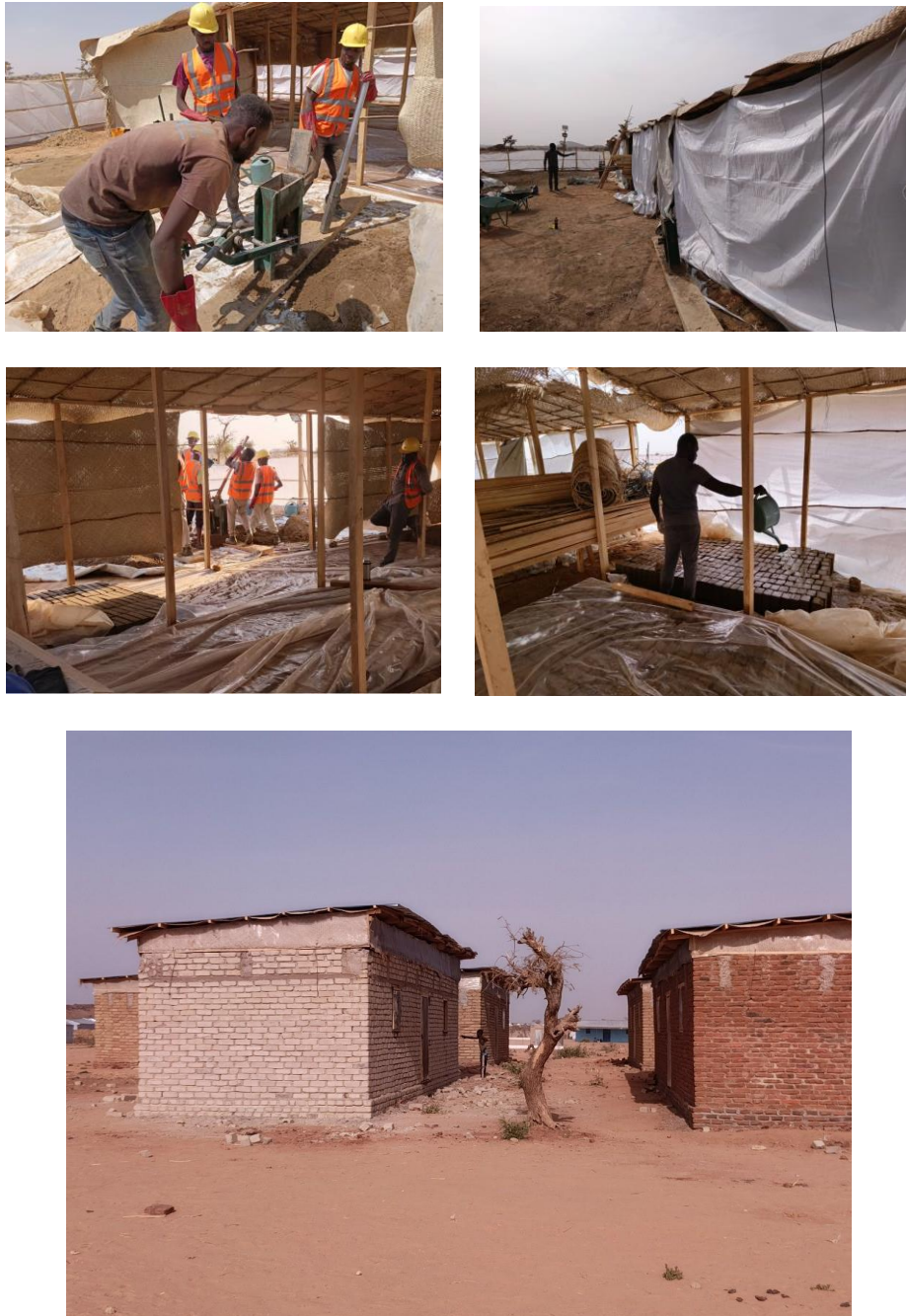
Fig 18, 19, 20, 21, 22, 23 et 24 – Plusieurs photos montrant la ligne de production de BTC sur site, utilisant deux presses manuelles et le stockage pour le séchage avant l'assemblage (18 à 23), ainsi que les prototypes finaux d'abris, construits en utilisant les différentes techniques de construction en terre mentionnées ci-dessus (24).
