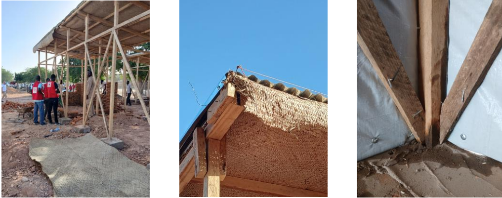
Figs 9, 10 and 11 – Premières photos des abris tests : la sous-structure en bois (9), la toiture en double couche (10) et les colonnes en bois protégées avec de l'huile de vidange (11), en novembre 2024.
