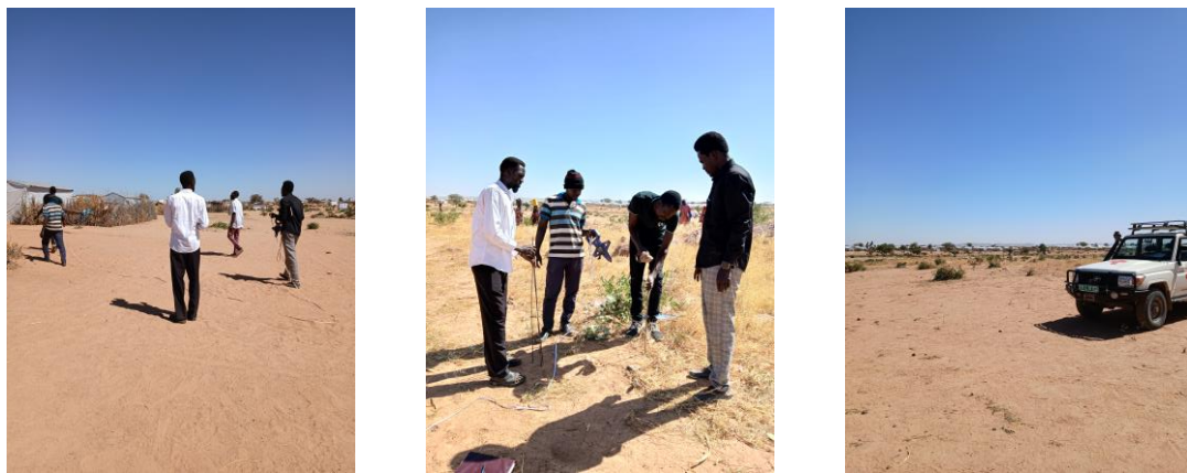
Figs 50, 51 et 52 – Photographies de la délimitation physique du terrain attribué après la signature du Procès-Verbal, en décembre 2024.
