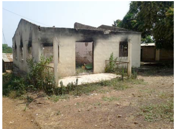
Maison en dur endommagé, Toulepleu Village, Département de Toulepleu
