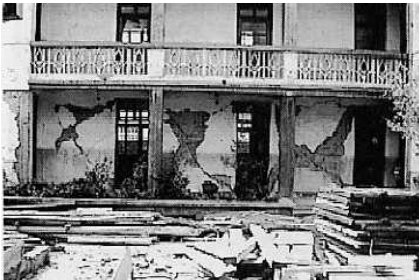
Foto 7: Daños sufridos por edificación a causa de un sismo (Obsérvense las grietas en diagonal en los muros)
