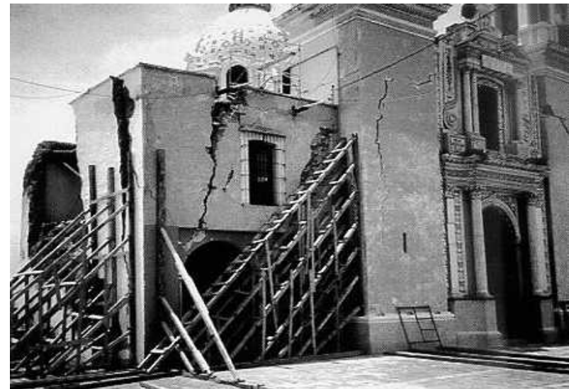
Foto 8: Daños sufridos por la iglesia Nuestra Señora de Los Remedios en Cholula, Puebla, construida en mampostería no confinada
