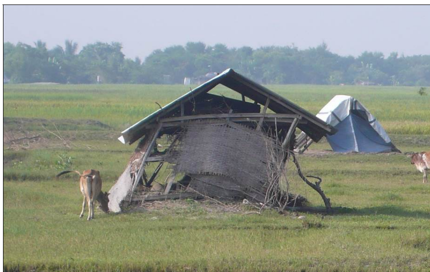
Basculement de la structure
