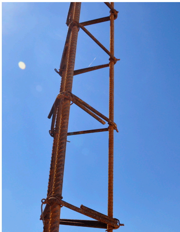
Certaines colonnes ont seulement trois barres d'acier ce qui est insuffisant.
