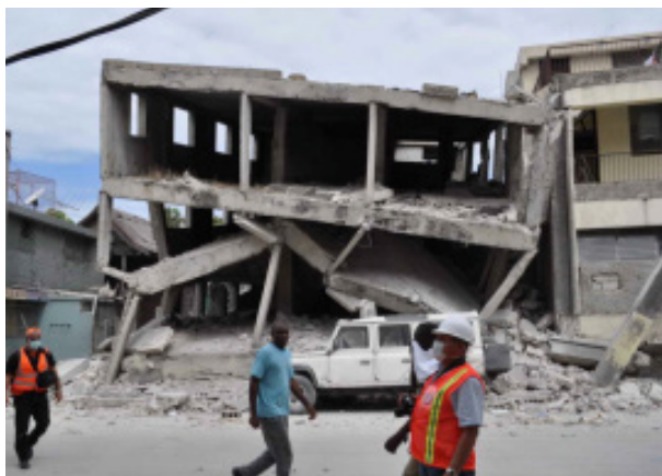
Bâtiment effondré notamment en raison de mauvaises connexions.
