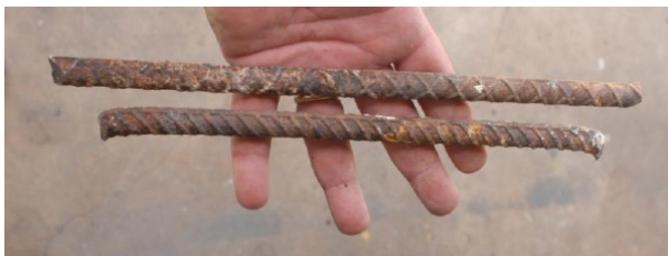
Acier corrodé - Ne jamais utiliser dans la construction
