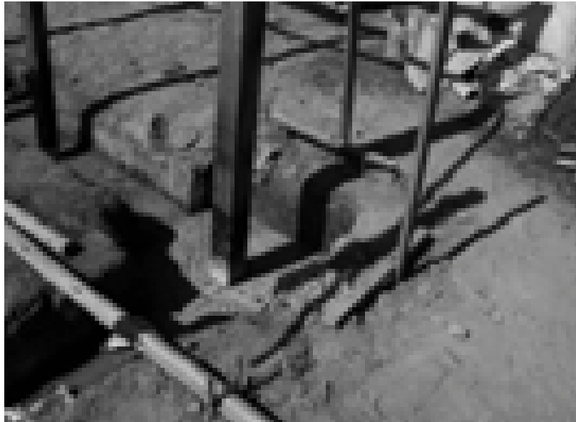
Los parantes se colocan sobre el solado del cimiento y las columnas principales en el solado de las zapatas
