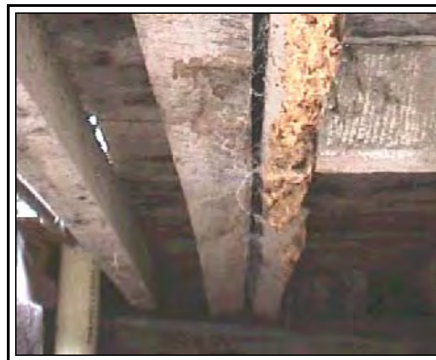
Viga de madera atacada por insectos xilófagos
