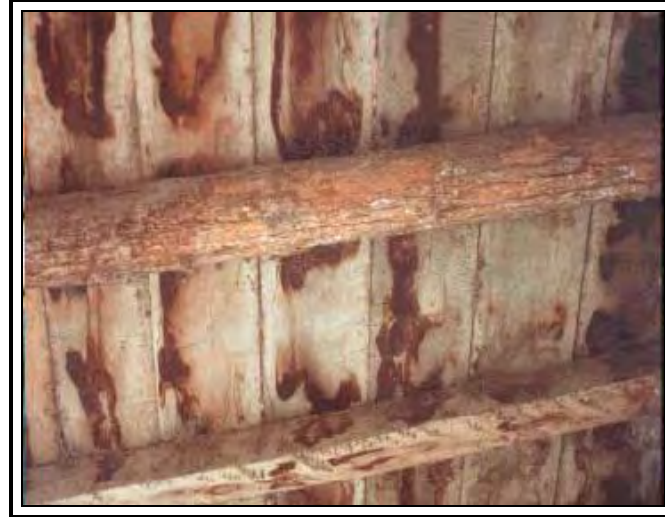
Pudrición de entrepiso por humedad
