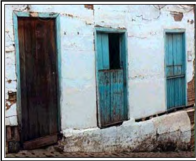
Daños por humedad en recubrimiento
