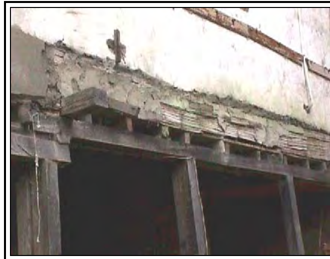
Pudrición por falta de recubrimiento
