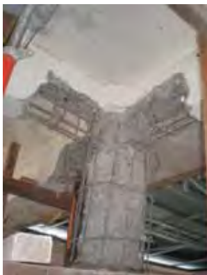
KOLOM YANG RUSAK, TULANGAN & SENGKANG KURANG
