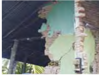
CONTOH KEGAGALAN DINDING DI SUDUT-SUDUT RUANGAN
