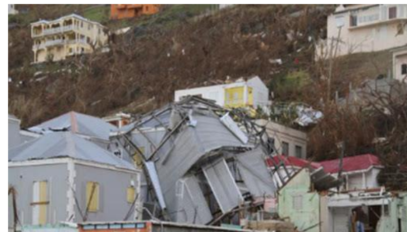
Hurricane Irma – BVI 2017
