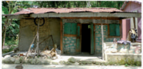
Grande Rivière : maison ayant survécu au séisme de 2010, avec structure en bois et remplissage en partie en maçonnerie de pierres et en partie en clissage avec mortier en terre.
