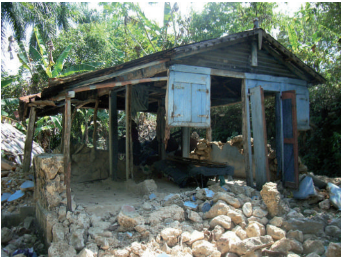
analyse des dégâts
