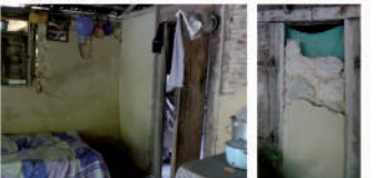
Endommagement partiel, lors du séisme de 2010, d'une paroi extérieure en maçonnerie de pierre et d'une cloison intérieure en clissage
