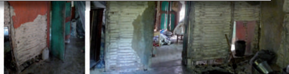
Endommagement de parois intérieures et extérieures lors du séisme du 12 janvier 2010
