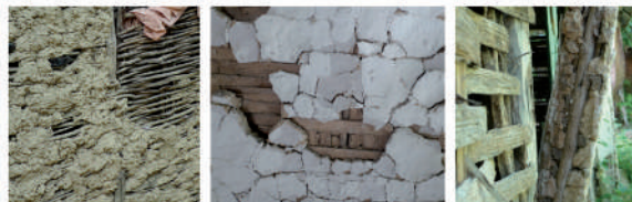
Clissage : lattes très serrées ne permettant pas la liaison entre le mortier des deux côtés du panneau
