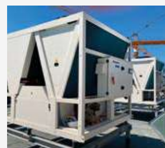
Cédrus Liget. En avancerad anläggning med bl.a. lägenheter, takvåningar och utställningslokaler. Szeged, Ungern. ECOi-W, ECOi och ERV.
