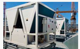
Cédrus Liget. En avancerad anläggning med bl.a. lägenheter, takvåningar och utställningslokaler. Szeged, Ungern. ECOi-W, ECOi och ERV.
