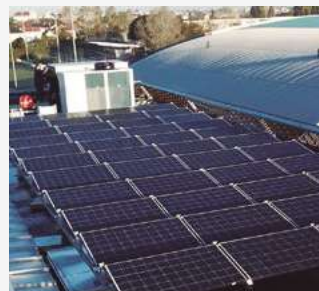
Amandiers. Idrottsanläggning. Carrierre sur Seine, Frankrike. ECOi-W.
