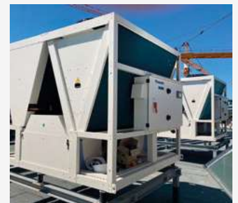
Cédrus Liget. En avancerad anläggning med bl.a. lägenheter, takvåningar och utställningslokaler. Szeged, Ungern. ECOi-W, ECOi och ERV.
