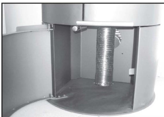
Uteluftsslangen bör kondensisoleras
