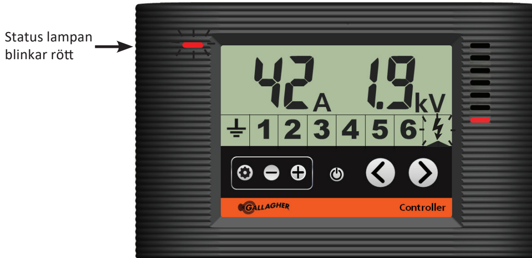
Kontrollen visar aggregat i ström larm
