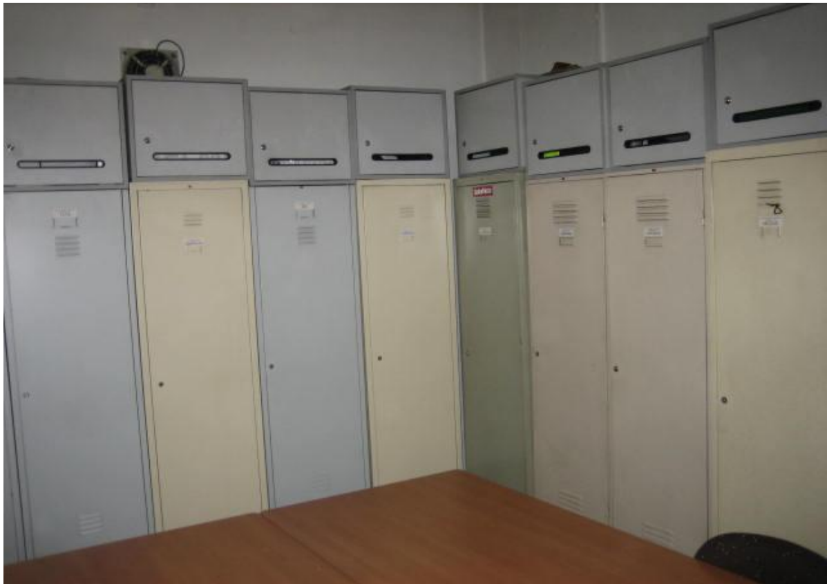
FOTO Nº 4, SITUACION DEL EXTRACTOR DEL VESTUARIO Nº 2 E INTERIOR DEL MISMO
