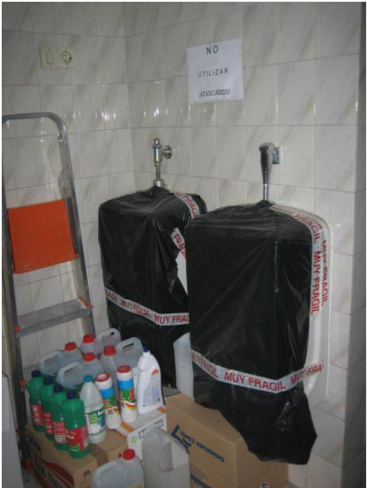
FOTO Nº 8 ASPECTO QUE PRESENTAN LOS DOS URINARIOS.-
