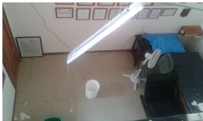
Estado de las instalaciones de Fiscal del puerto de Vigo
